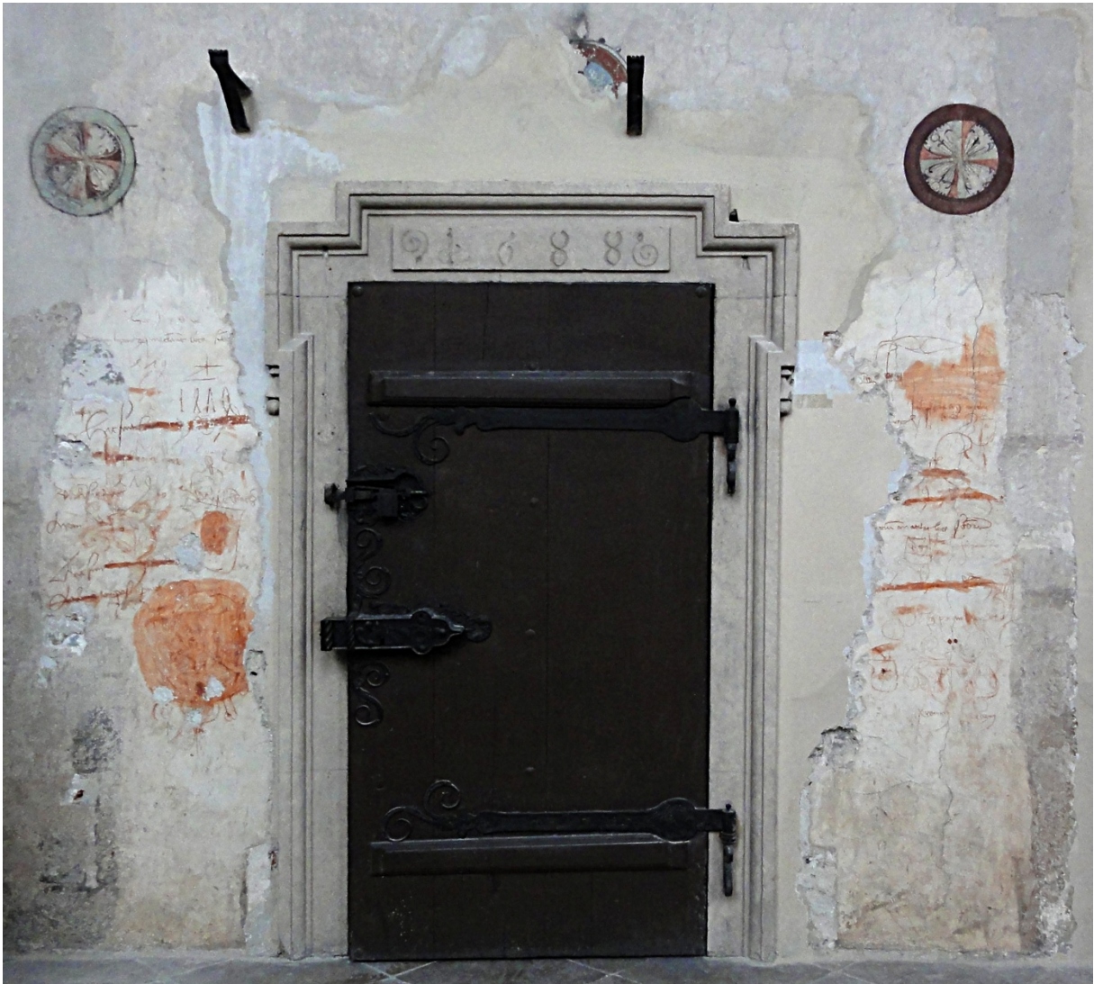
Abb. 3: Die Graffiti zu beiden Seiten des in der Barockzeit neu eingefügten Türrahmens
