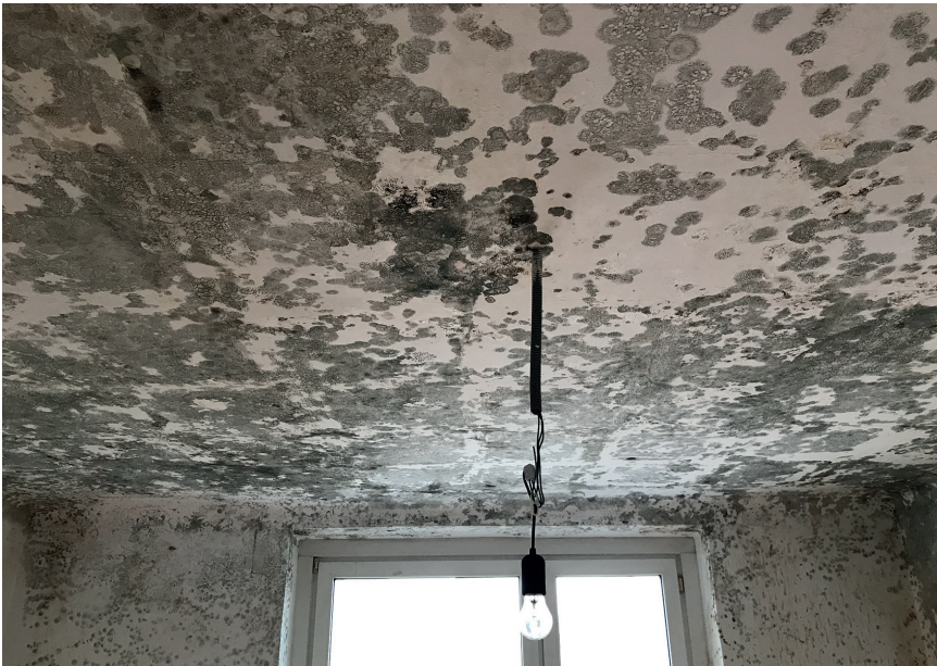
Abb. 1: Massiver Schimmelbefall nach Wasserschaden.
