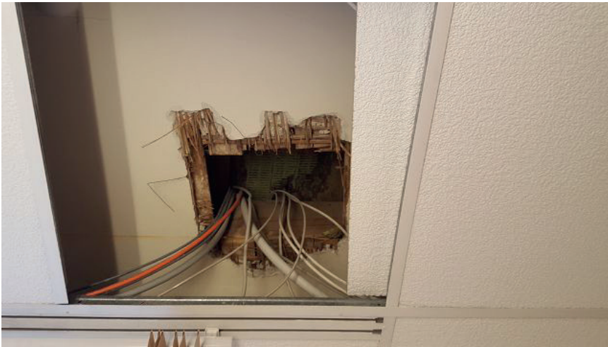
Abb. 2: Luftströmung von einem Büro in ein darüber liegendes durch Zerstörung der luftdichten Ebene zwischen den Geschossen – der Schaden liegt oberhalb der abgehängten Decke und war daher nicht sichtbar.
