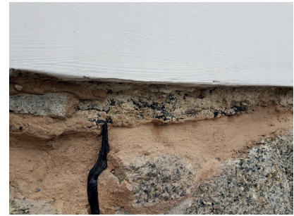
Abb. 1: Etwa 100 Jahre alte Teerabdichtung im Sockelbereich als Geruchs- und Schadstoffquelle.
